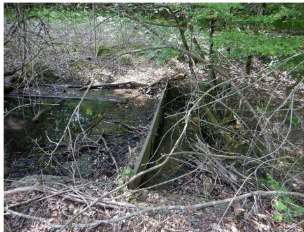
Déversoir encombré (OH448)
