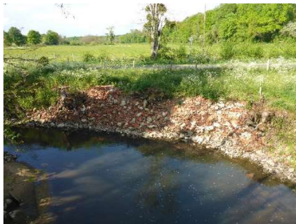
Erosion en rive droite
