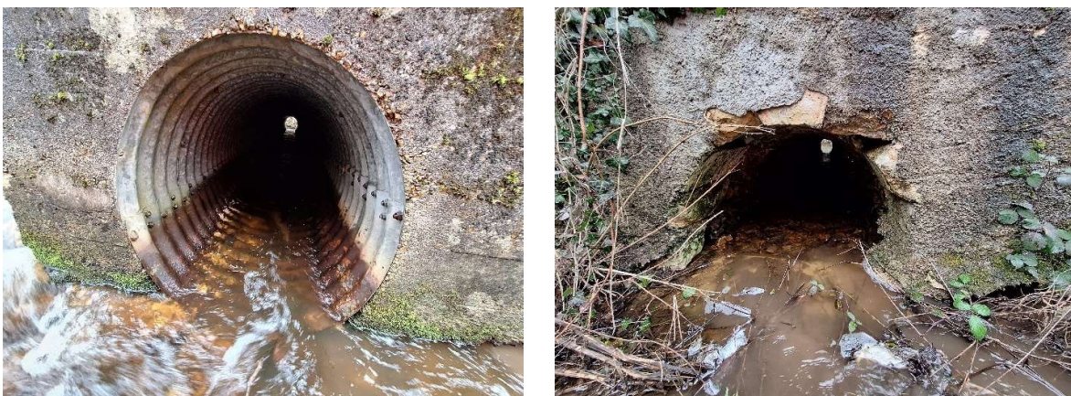
Figure 6 – Désordres au droit de l'ouvrage
