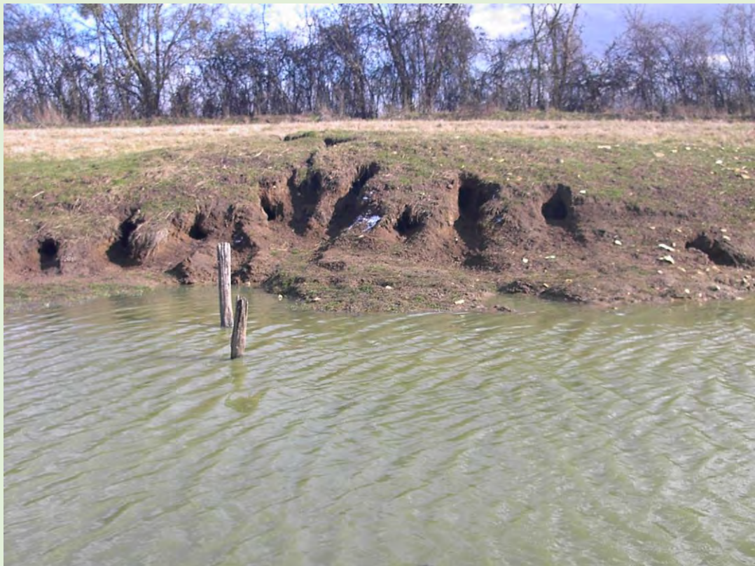
Dégâts de Ragondins sur berges, FDC18
